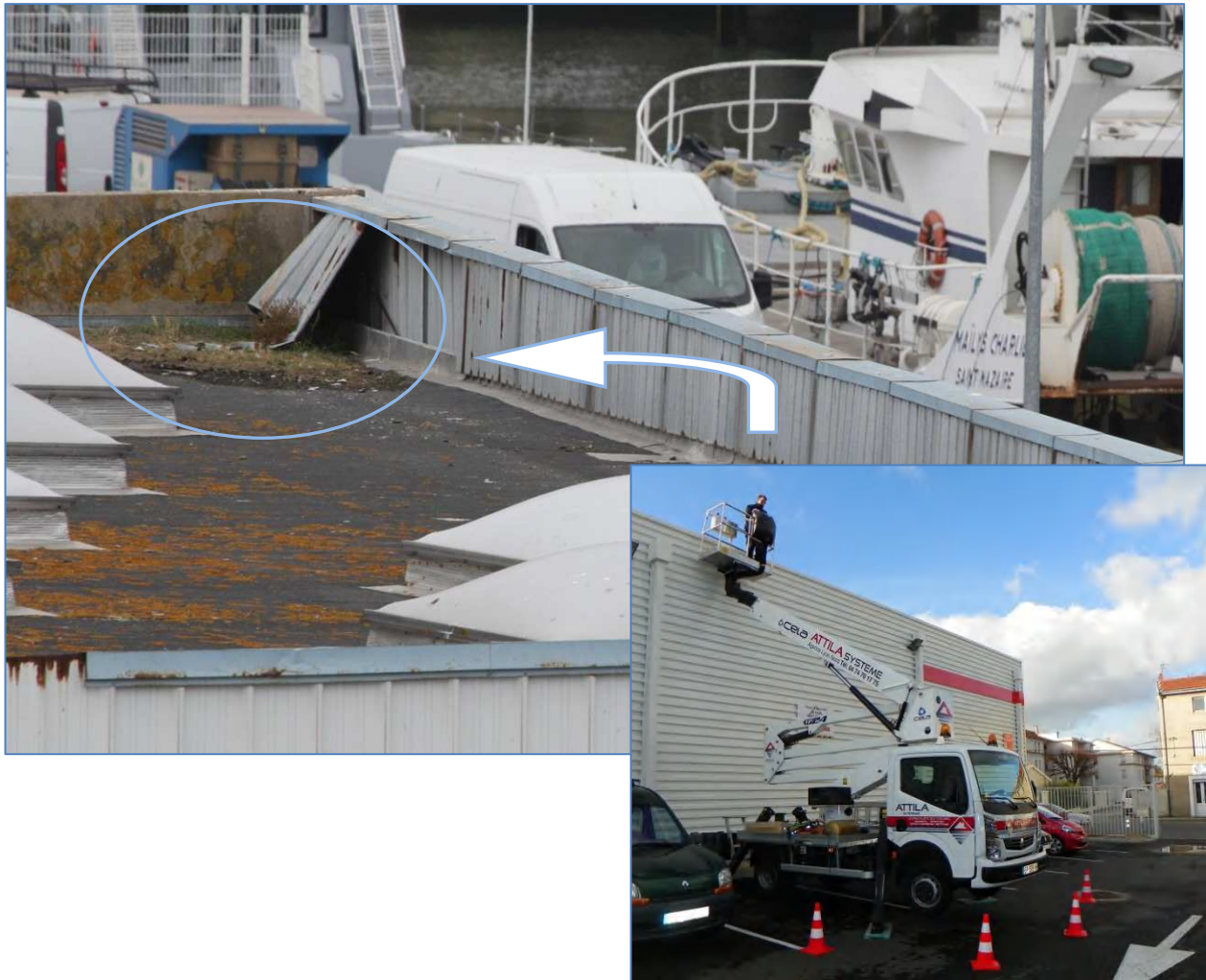
Figure 2: technique d'approche d'un toit plat via un camion nacelle. Au dernier plan, un SAO repéré après envol d'un goéland argenté (cliché : Matthieu FORTIN – Bretagne Vivante).
